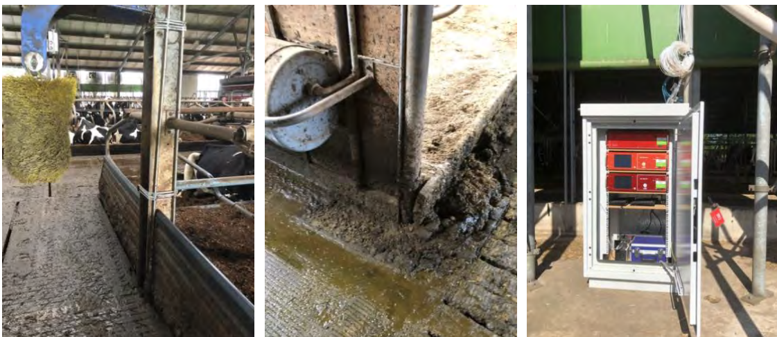
Figuur 3: De linker en de middelste foto laten zien hoe de meetleidingen onder de vloer gaan. De foto rechts is een voorbeeld van de apparatuur, die buiten in een geïsoleerde kast staat.
